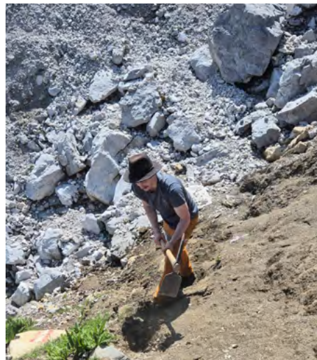
Oberer Nordweg – neue Stufen werden benötigt
